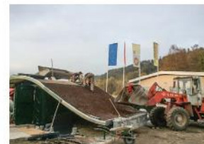
Slika 50: Ekstenzivna, nagnjena zelena streha s travnimi rešetkami za utrjevanje oziroma zadrževanje substrata (foto: Čufer, T., 2017)
