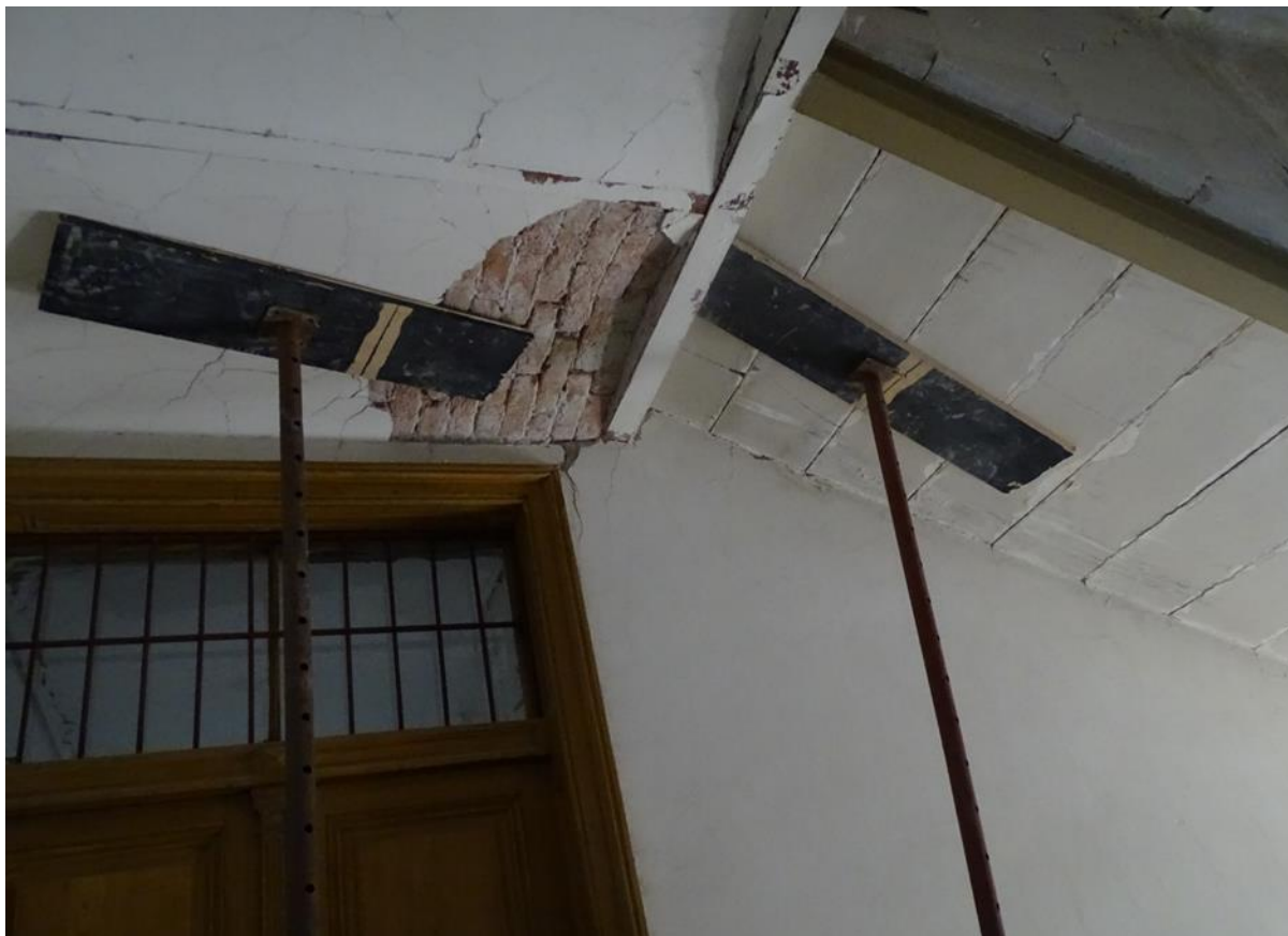
Oštećene kamene stube i polje plitkog bačvastog (pruskog) svoda zbog pada dimnjaka
